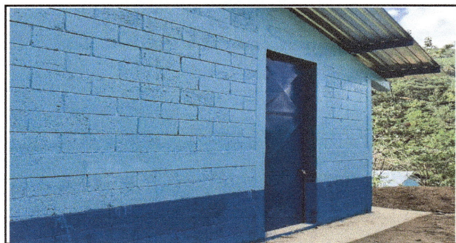
Foto 5: Mantenimiento realizado a puerta módulo 1
